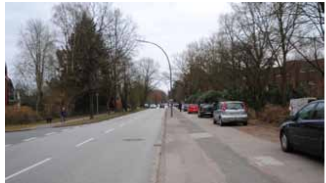
136 Frequentierte Straße mit Modernisierungsbedarf (Rissener Landstraße)
