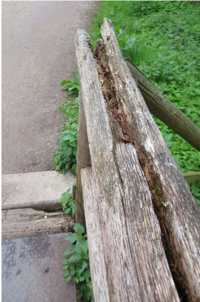
Verletzungsgefahr Handlauf – zudem nicht stabil
