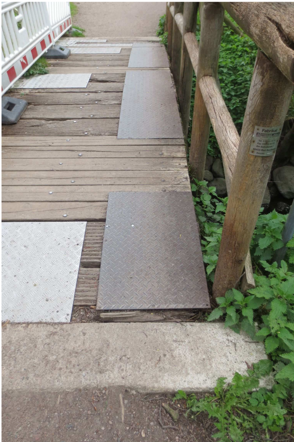
Material-Mix mit Lücken & Absätzen, Rutschgefahr Metallflächen, Verletzungsgefahr herausstehende große Schraubenköpfe Stolpergefahr durch Absätze, Spalten, Löcher; Kunststofffüße der rot-weißen Absperrgitter ragen in Geh-/Fahrbereich
