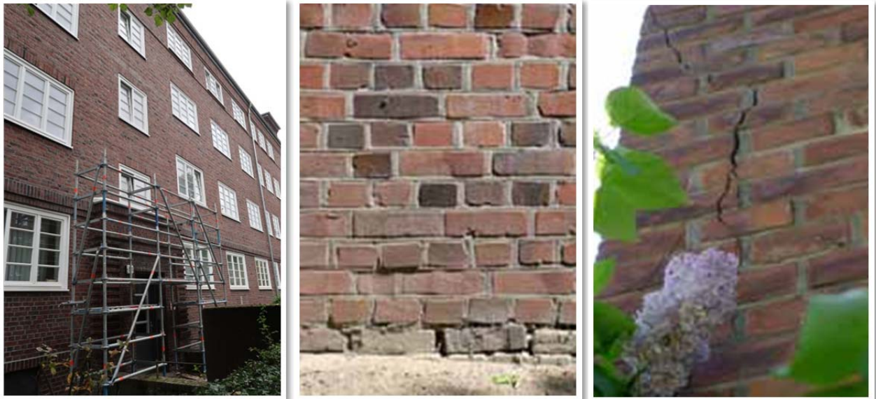
Abb. 8: Beispiele für Modernisierungs- und Instandsetzungsbedarfe
