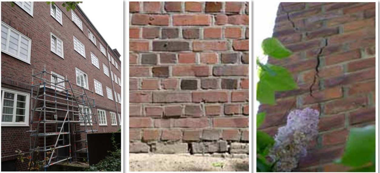
Abb. 8: Beispiele für Modernisierungs- und Instandsetzungsbedarfe
