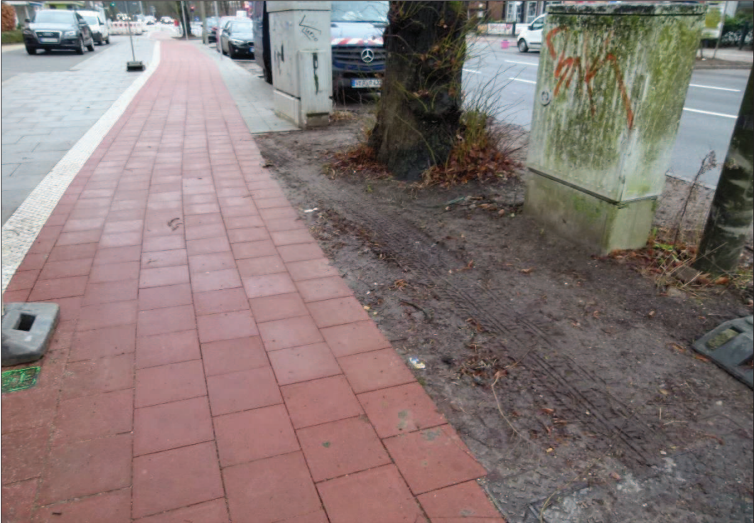
Bild 3 Beschädigungen der Baumscheiben
