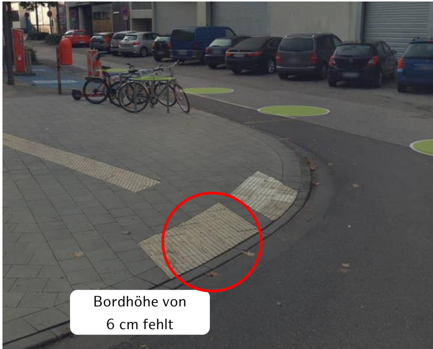
Ungesicherte Querungsstelle an der Kreuzung Schlossstraße / Vinhagenweg
