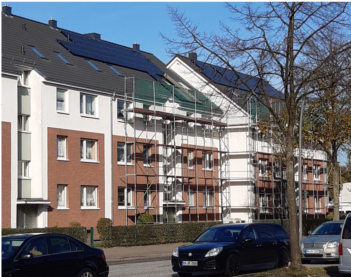
Abb. 29: Photovoltaikanlage auf dem Dach Schiffbeker Weg 15 – 19 (Foto © Fachamt Stadt- und Landschaftsplanung)
