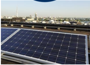
Beispiel PV-Anlage © FHH-Mediaserver
