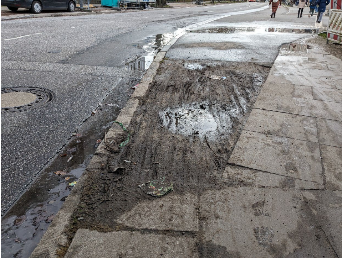
Harkortstraße gegenüber Hausnummer 164, Matsch und Rutschgefahr
