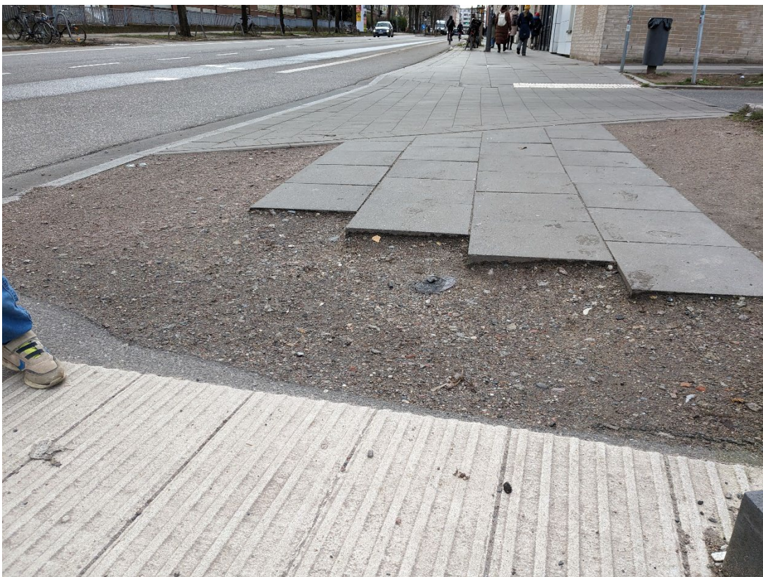
Harkortstraße gegenüber Hausnummer 164, Erosion und Kanten
