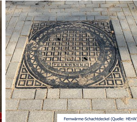
Fernwärme-Schachtdeckel (Quelle: HEnW)
