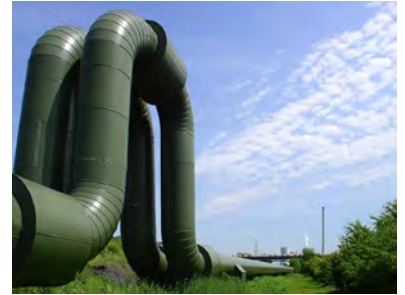
Quelle der Fotos: pixabay, Fernwärmeleitung
