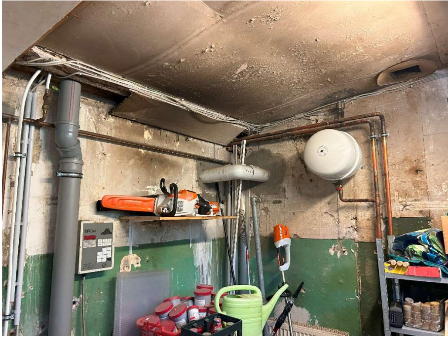
Heizungsleitungen im Abstellraum müssen gedämmt werden
