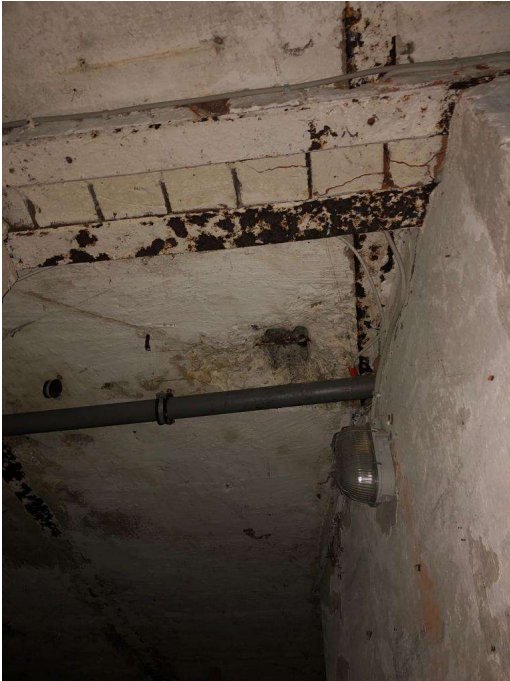
Kellerdeckendämmung unterhalb des Speisesaals fehlt
