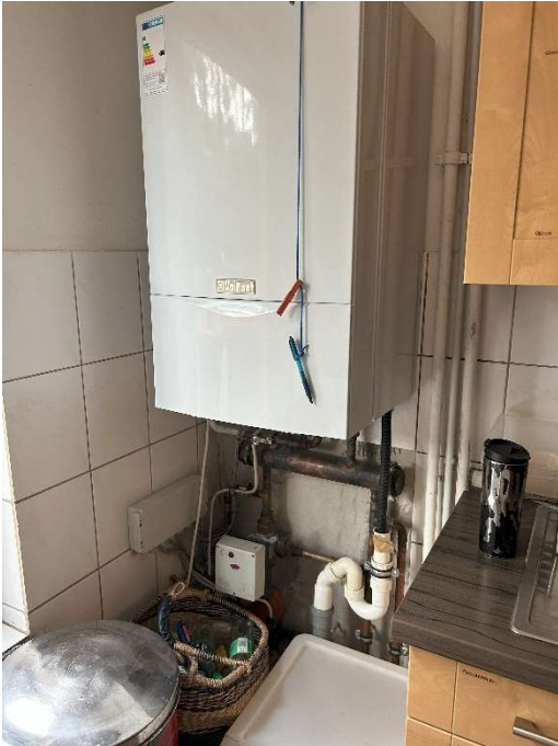
Heizung Viessmann ca. 20 Jahre alt
