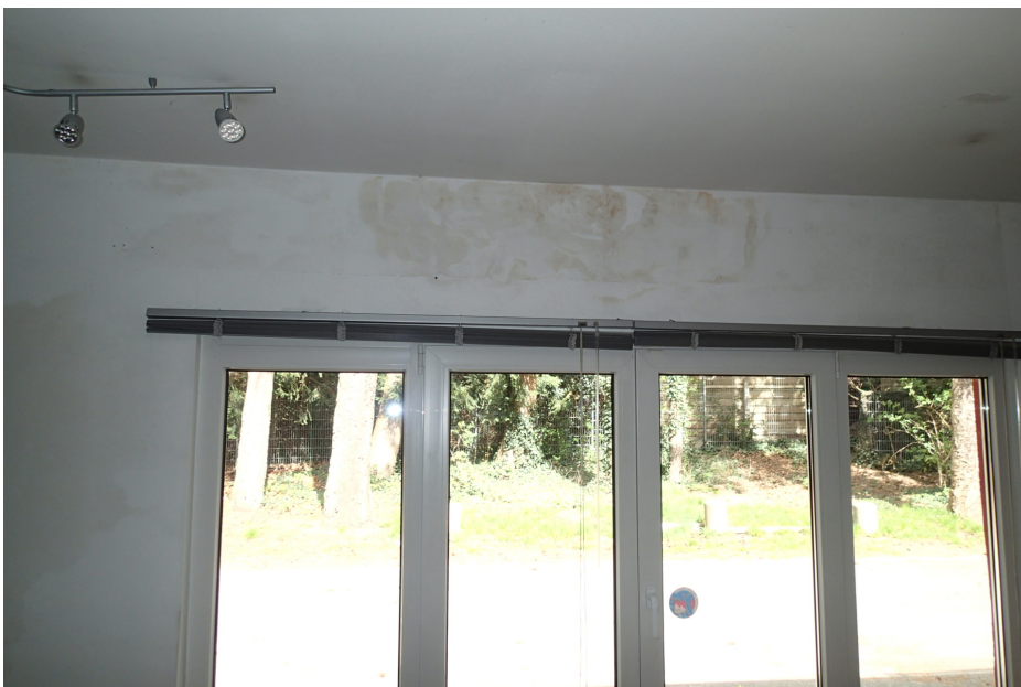
Bild 2 : Durchfeuchtung innen am Sturz
