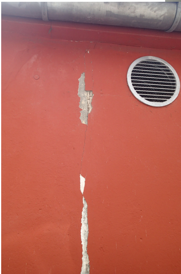
Bild 6 : Riss auf der nördlichen Wand
