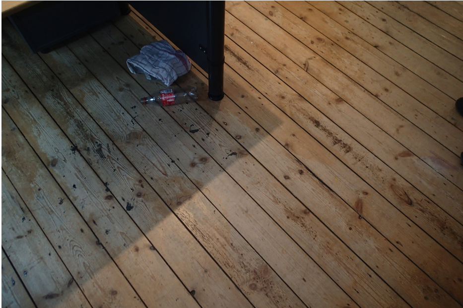
Bild 11 : Dielenboden, leicht geschädigt
