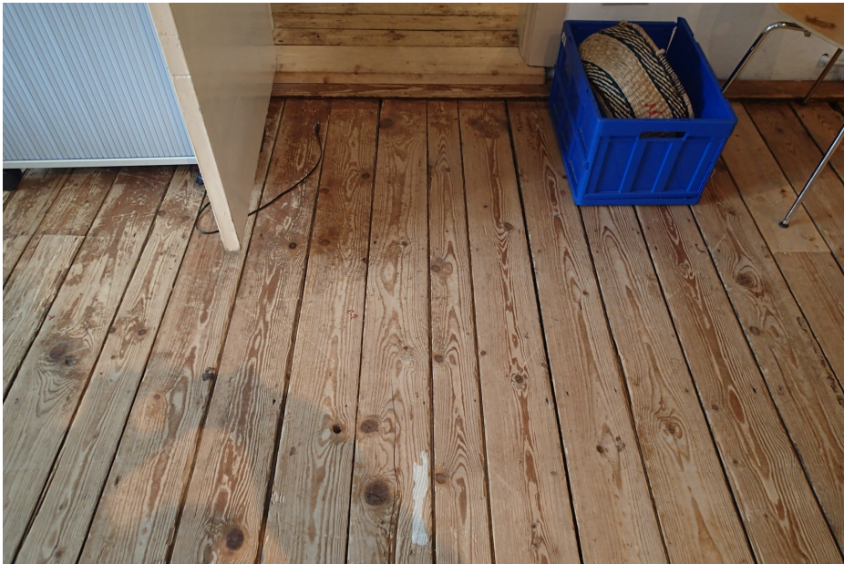
Bild 10 : Stark geschädigter Dielenboden
