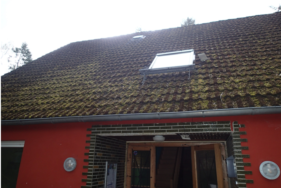
Bild 15 : Eingangsbereich Dach mit Moos
