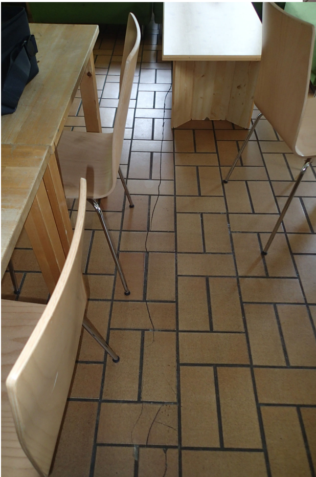
Bild 4 : Riss im Fliesenbereich
