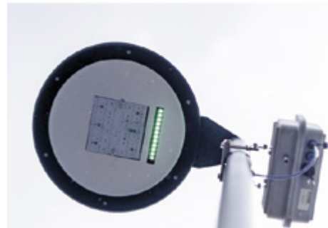
Abb. A2: Eindrücke vom Testgelände des Danish Outdoor Lighting Lab (DOLL) für intelligente Beleuchtung. Zur Verfügung gestellt von DOLL.
