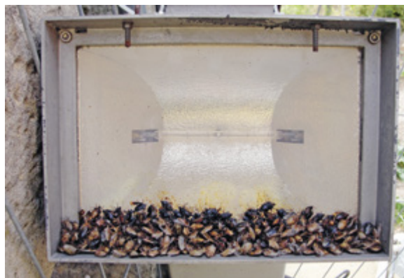
Abb. 5: Sind Leuchtkörper nicht abgeschirmt, können Insekten in großer Zahl eindringen und zu Tode kommen. Es sollte deshalb bei Außenbeleuchtung immer mindestens die Schutzklasse IP64 zum Einsatz kommen. Foto: Reinhold Schaal
