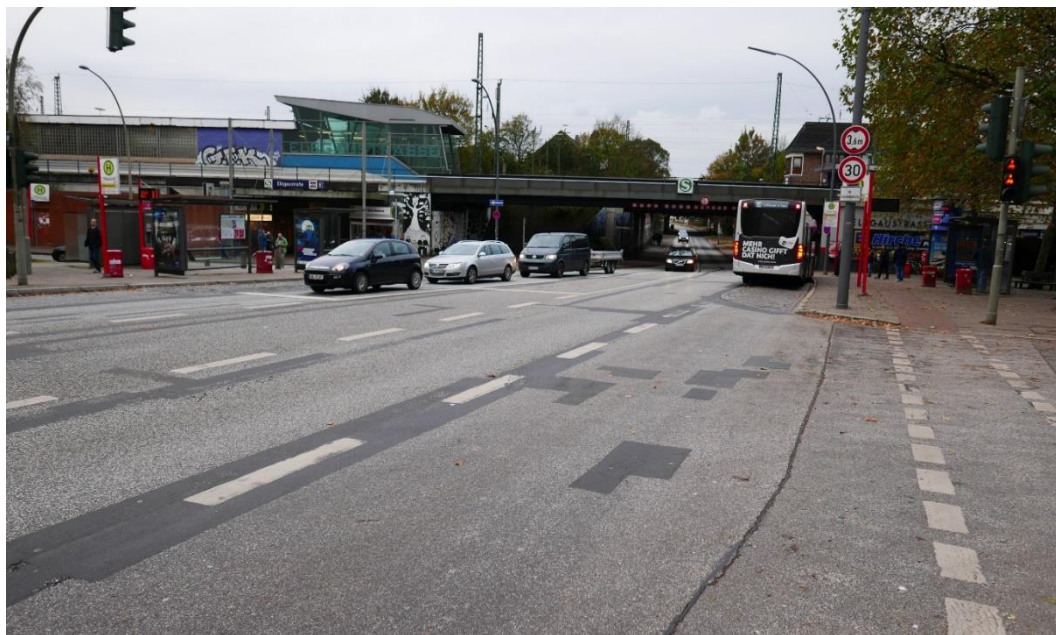
Abbildung 3: Schadensbild an der S-Bahn- und Bushaltestelle Elbgaustraße
