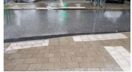
Bild 6: Beispielfoto ungesicherte Querungsstelle mit differenzierten Bordhöhen (Quelle: Eigene Aufnahme 2022)
