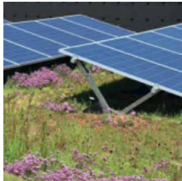
Extensives Photovoltaik-Gründach: G4 Gewerbe
