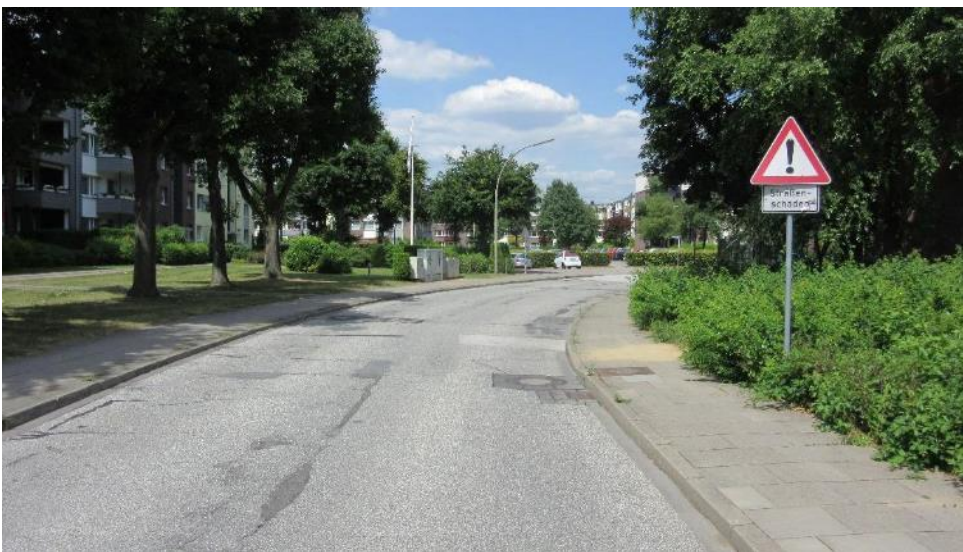
Abb. 32: Nördlicher Abschnitt des Friedrich-Frank-Bogen mit Sanierungsbedarf
