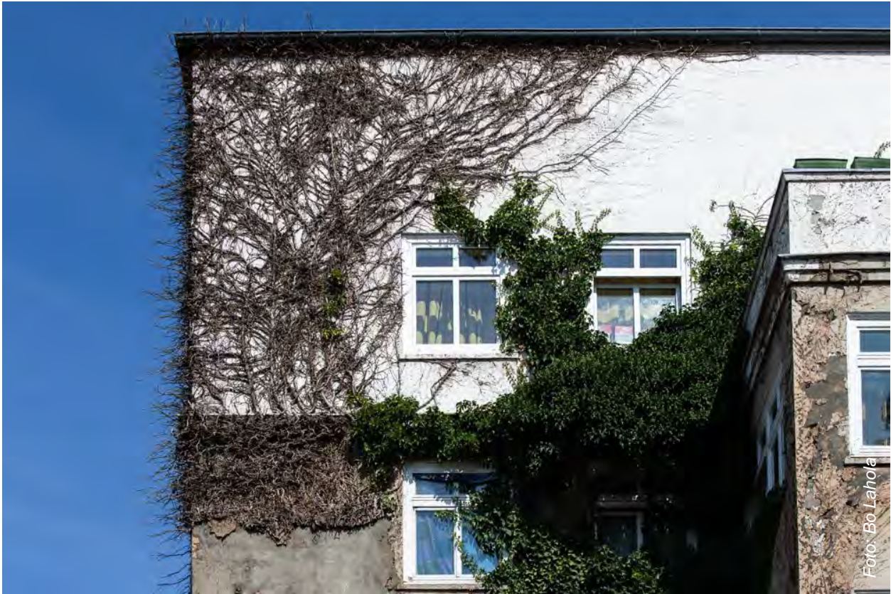
Abb. 13 Sanierungsbedarf im Bahnhofsviertel, Foto © Fachamt Stadt- und Landschaftsplanung
