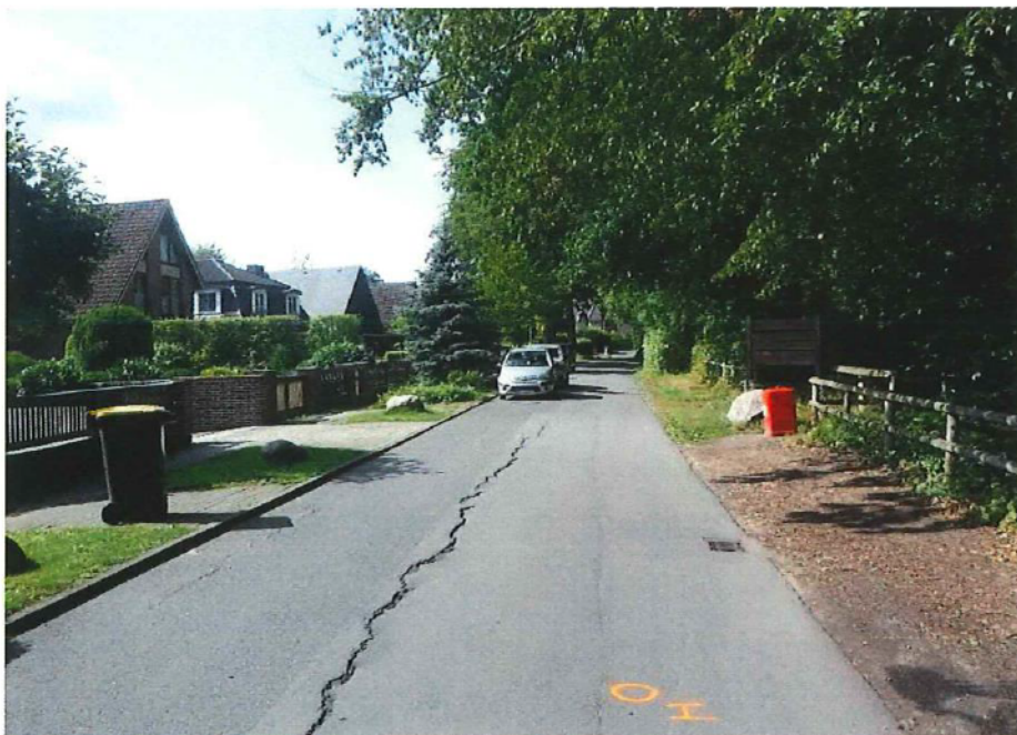
Bild 1: Riss in der Fahrbahnoberfläche vor Haus Nr. 5/7 (entnommen aus dem Befund 6204/19)
