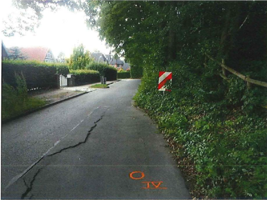
Bild 2: Riss in der Fahrbahnoberfläche vor Haus Nr. 11/13 (entnommen aus dem Befund 6204/19)
