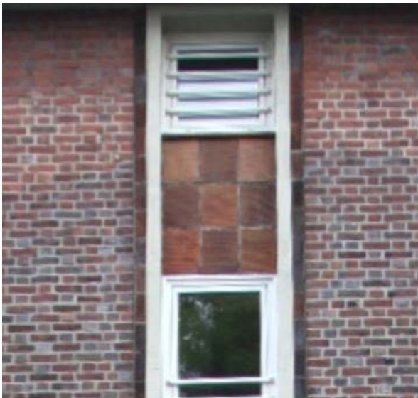
Abb. 34 Die Zäsuren zwischen dunklerem Klinker in seinen unterschiedlichen Schattierungen (unten), dem helleren Backstein des Wiederaufbaus (oben) sowie Fliesen in der Treppenhausachse zeichnen sich deutlich in der Fassade ab
