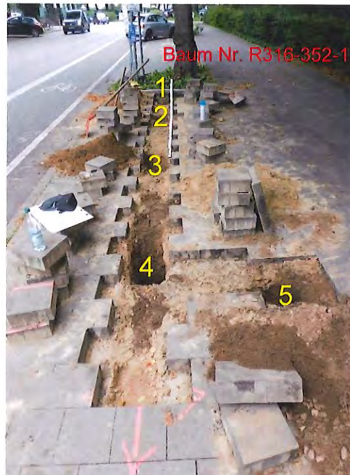
Abb. 2: Suchlöcher, nummeriert von 1-5(Blick aus Süd)
