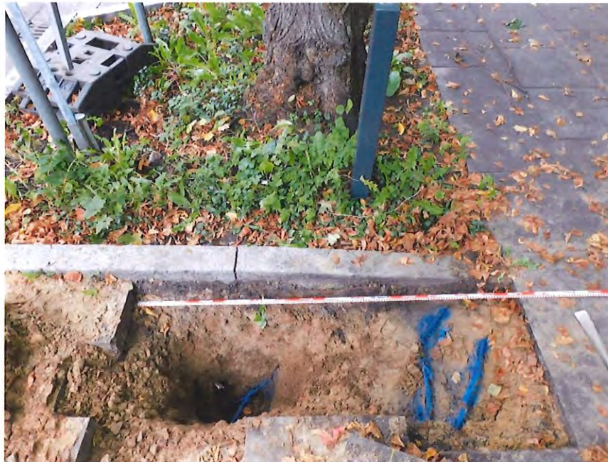
Abb. 8: Schwachwurzelwerk direkt unter dem Pflaster in der Ausgleichsschicht, Stammabstand 1,3 m
