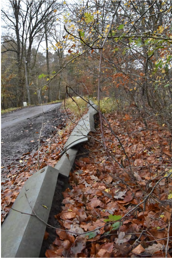
Foto 3: Beschädigte Leitelemente am Klövensteinweg
