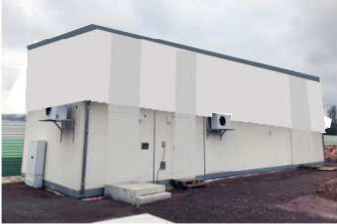
Das Modulgebäude des ESTW-A (ausgelagerte Stellrechner) Haunetal-Neukirchen mit Satteldach (Februar 2018) [Quelle: DB Netz AG]
