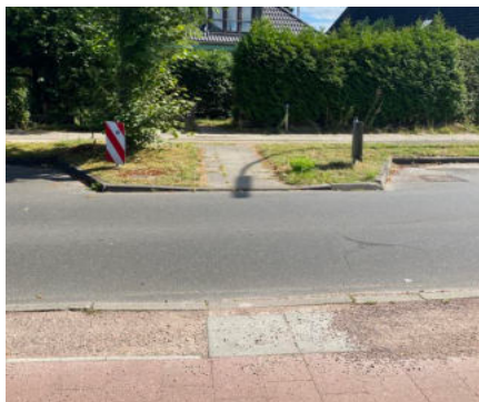
Nicht barrierefreie und zu schmale Gehwegvorstreckung am Redingskamp
