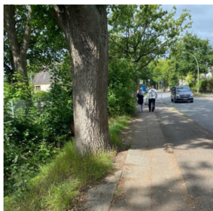
Baumwurzel drückt die Gehwegplatten hoch (Lohkampstraße)
