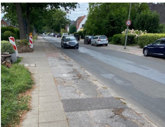
Zugewachsener Gehwegbereich und stark beschädigter Radweg.
