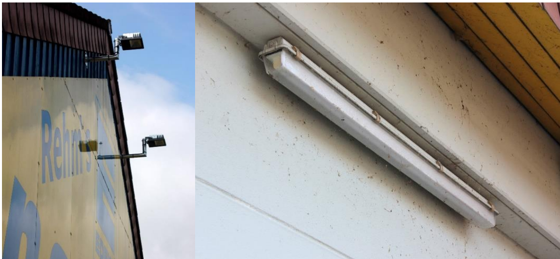
Abb. A9. Außenbeleuchtung eines Lebensmittelgeschäfts in Hilders bei Tag. Die Strahler an der Fassade haben einen engen Lichtkegel und strahlen ausschließlich nach unten. Die Leuchtstoffröhre wurde zu den Seiten abgeschirmt. Fotos: A. Hänel.
