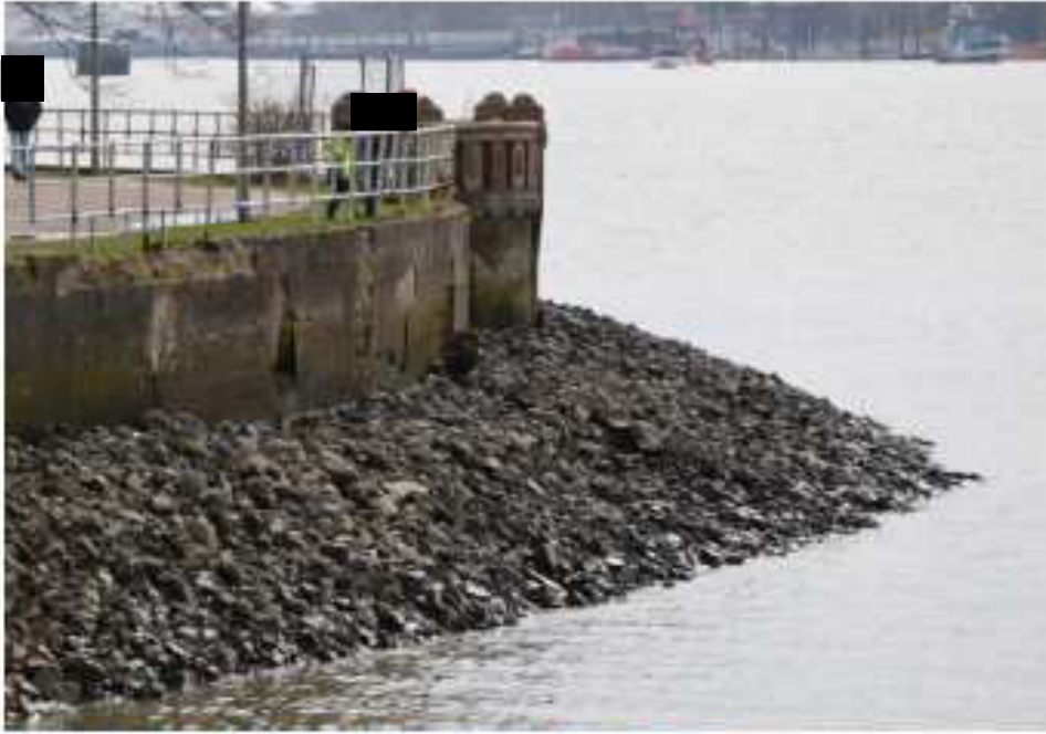
Abbildung 3-1: Deckwerk, Kolkbildung [HPA 2016]
