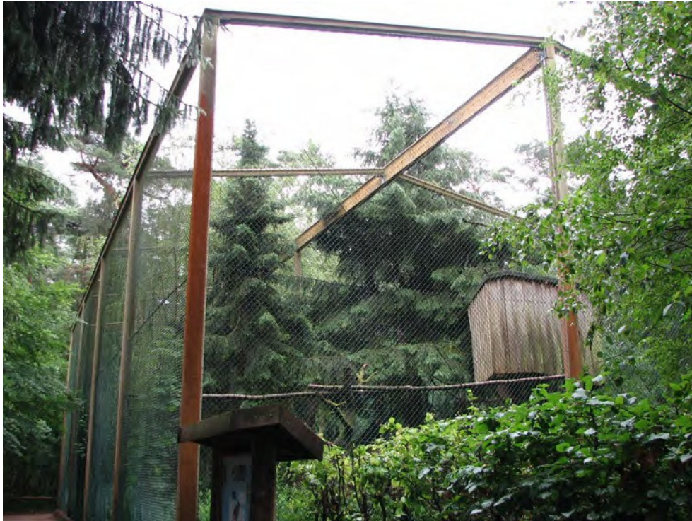
Illustration 3: Große, gut strukturierte Uhuvoliere mit dringendem Sanierungsbedarf
