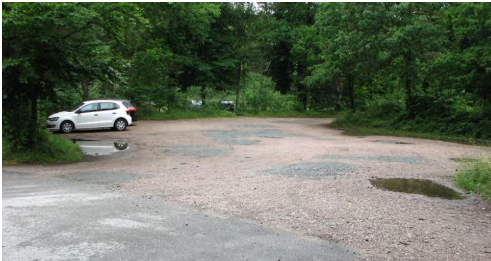
Illustration 16: Entwässerungsprobleme am Parkplatz
