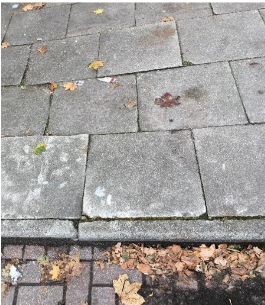
Abb.8: unebene und beschädigte Bodenplatten
