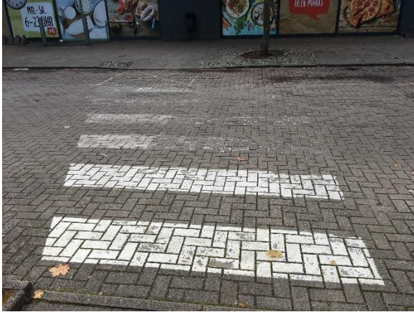
Abb.5: ausgebleichener, diagonal verlaufender Fußgänger*innenüberweg
