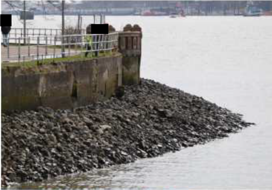
Abbildung 3-1: Deckwerk, Kolkbildung [HPA 2016]
