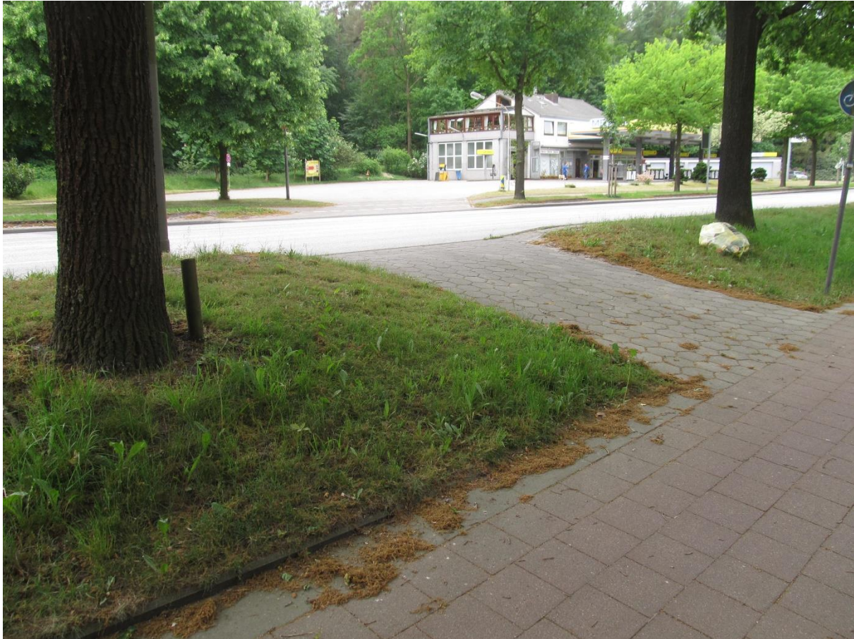
Abbildung 6: Höhenversatz auf der nördlichen Straßenseite der Cuxhavener Straße
