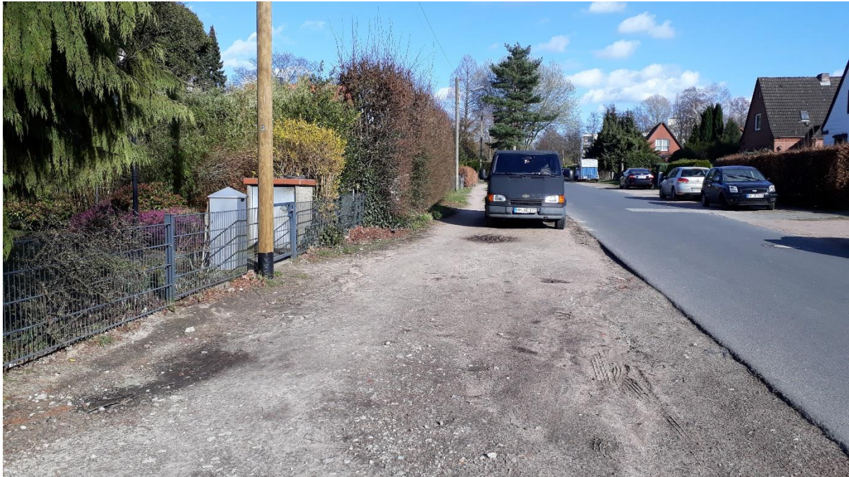
Bild 2: Von Fahrzeugen stark beschädigter und teilweise zugeparkter Gehweg
