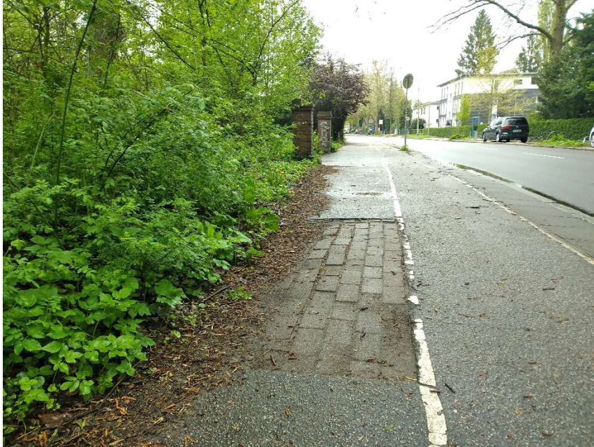
Überwucherung des Gehwegs mit Verunreinigung durch angesammelte Biomasse
