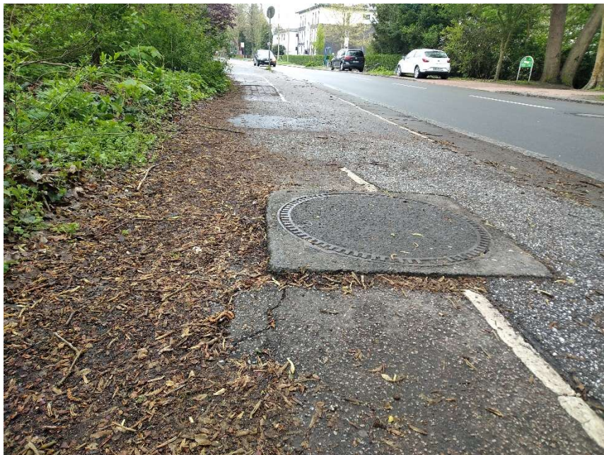
Risse und Unebenheiten im Geh- und Radweg
